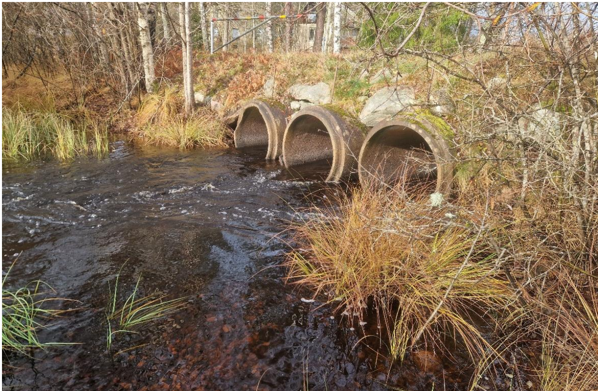
Figur 15. Vandringshinder fyra som utgörs av tre vägtrummmor i Drägvedsåån
