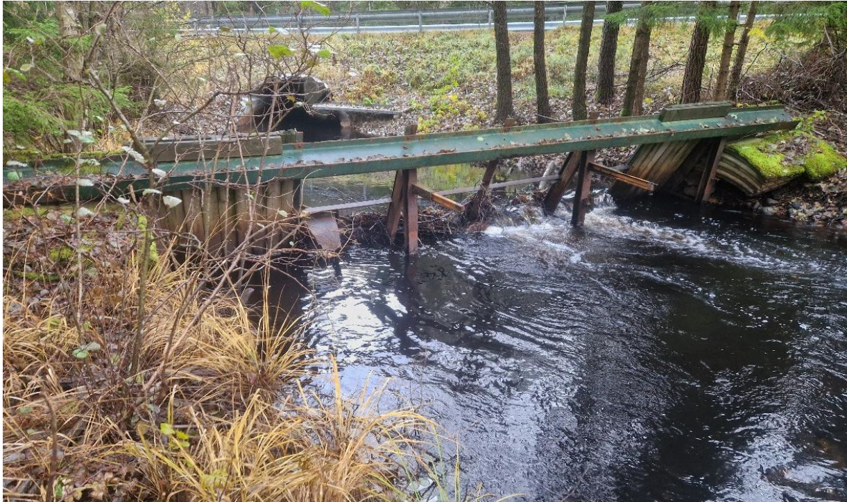
Figur 14. Vandringshinder 3 som utgörs av en metallkonstruktion med tillhörande brädor.
