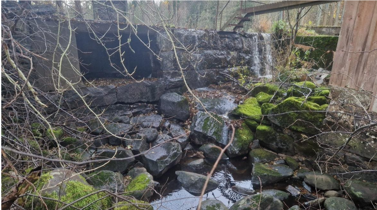
Figur 11. Torrlagd fåra vid dammen som bör åtgärdas.
