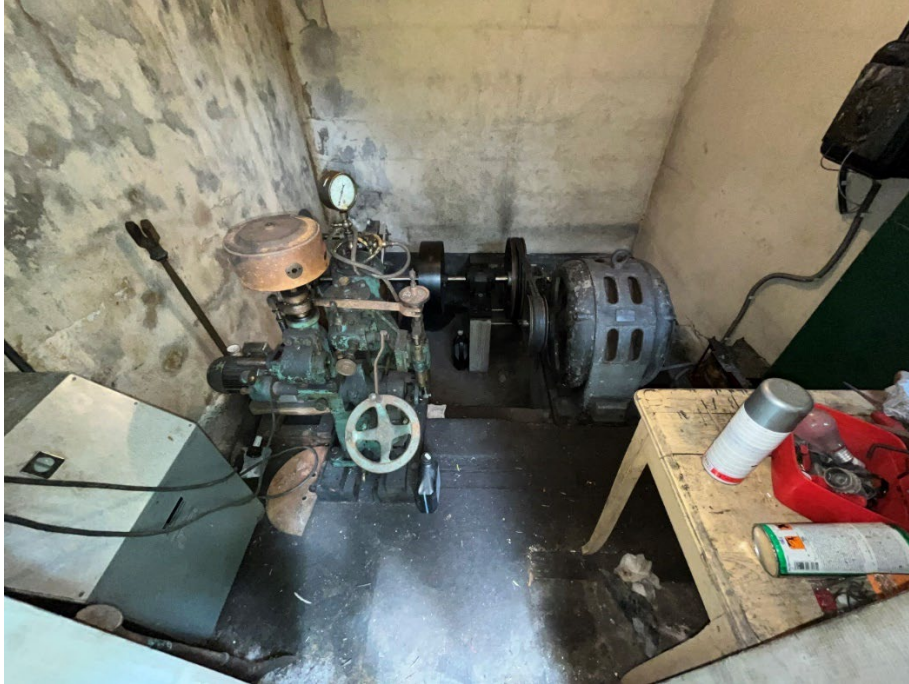
Figur 16. Vidbyggda kraftverket från 1940 med generator och turbinregulator.
