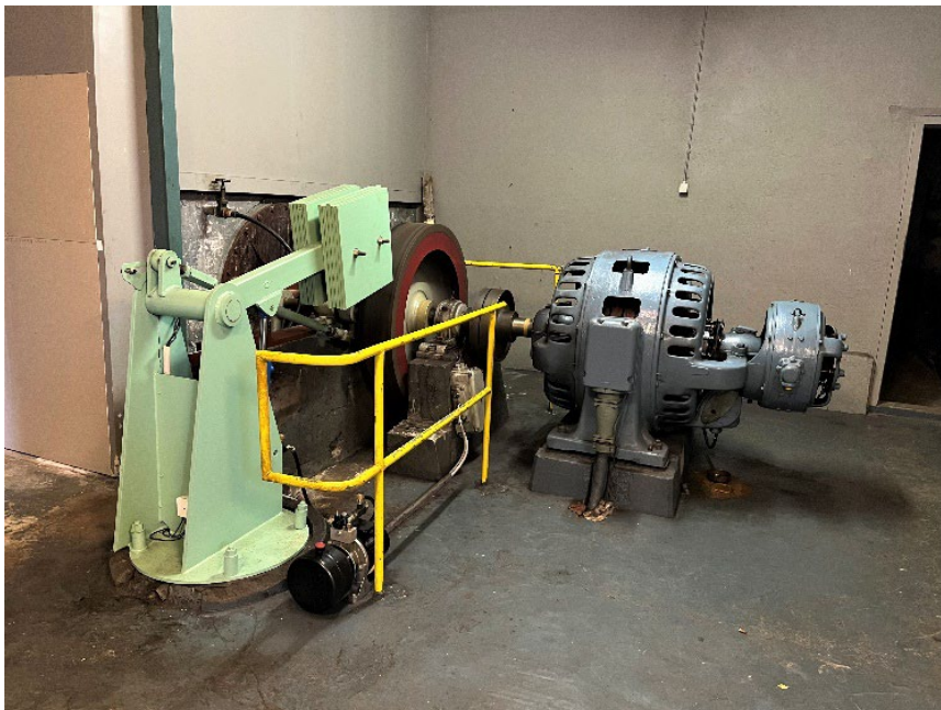
Figur 47. Ursprunglig Francis tvillingturbin från Hällarydsverken och generator från Asea.
