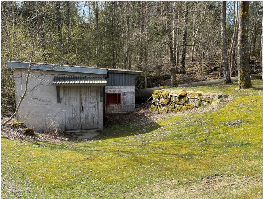
Figur 35. Tocknarås kraftverk med intagstub i glasfiber. Foto, Länsstyrelsen Halland 2022.
