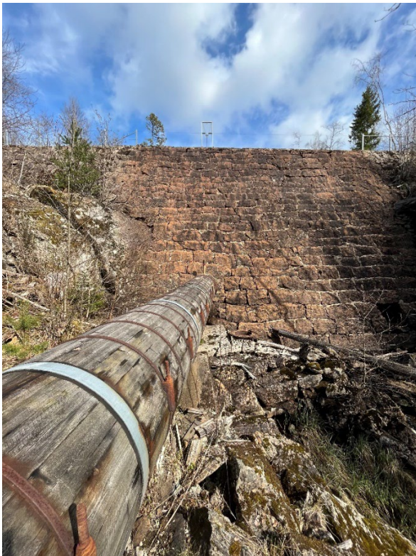
Figur 39. Ivarsfors imponerade överfallsdamm i huggen granit. Vid dammfoten höger om tuben syns betongplatta och turbinsugrör från 1918 års kraftverk. Foto, Länsstyrelsen Halland 2022.
